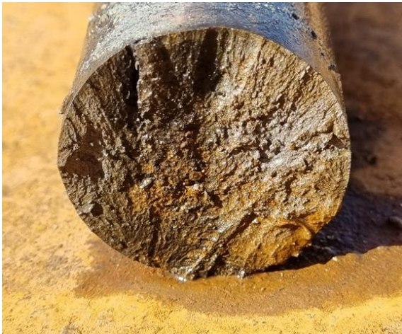
Foto 7 Breukvlak voorspanstaven (bron: Rijkswaterstaat)
